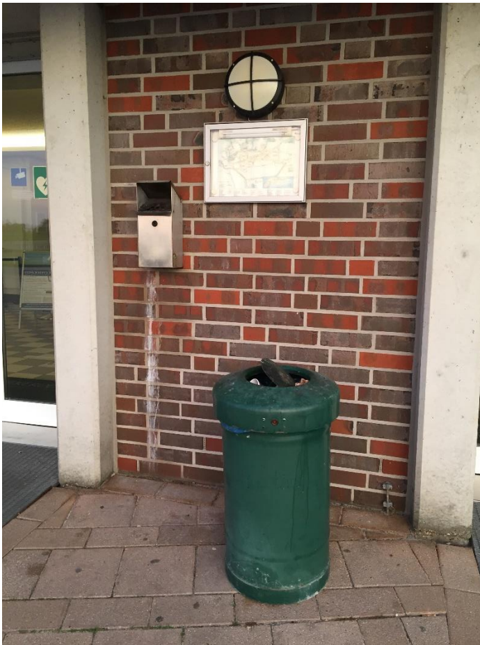
Abbildung 18: Rechtsseitiger Mülleimer und Aschenbecher am Eingang des Hafengebäudes in Neuuharlingersiel | Quelle: Eigene Aufnahme, S8
