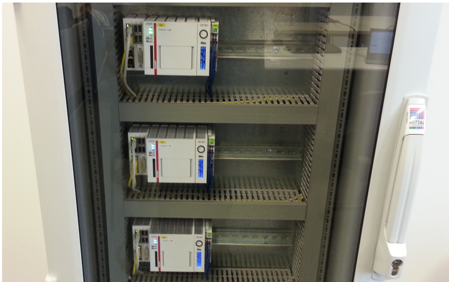
Abb. 5.7 Hardwareaufbau im PG-Raum
